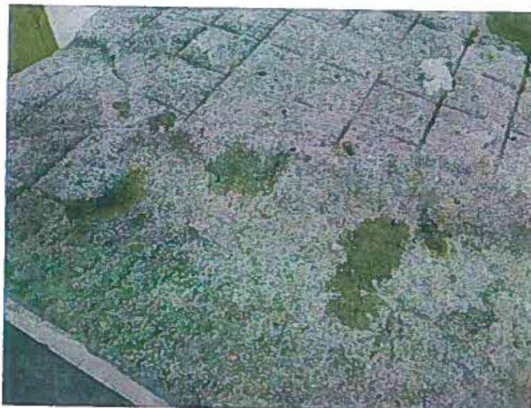
Foto 2 Vochtige plekken in de zand-cementvloer.
