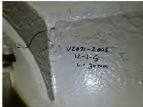
Figuur D 3 Voorbeeld van een scheur in een steun (foto 3867 uit [4]).
