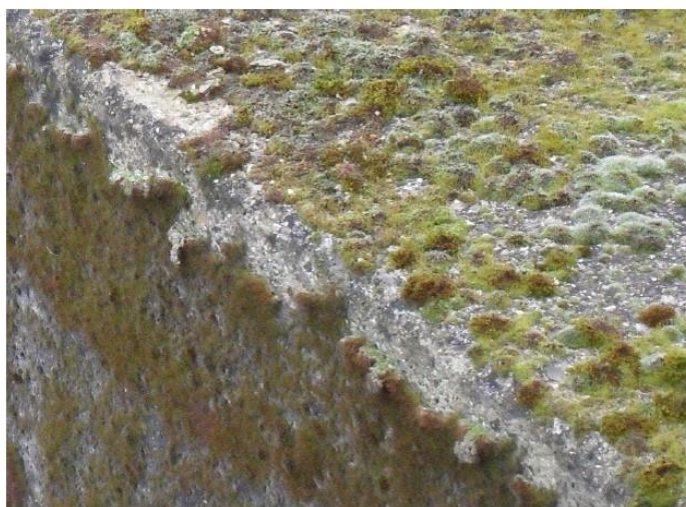
Figuur 5.5: Plaatselijke schade aan het betonoppervlak van een stempel (foto B.20 in [02])
