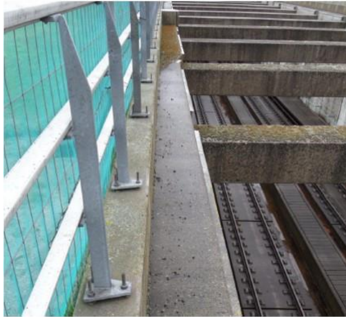
Figuur 5.7: Overgang van gording (met duidelijke mosgroei) naar de wand tussen de toegang en de tunnel (geen mosgroei) (foto B.31 in [02])
