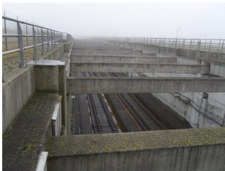
Figuur 5.6: Enigszins lijnvormige mosgroei, vermoedelijk ter plaatse van scheurvorming (foto B.25 in [02])
