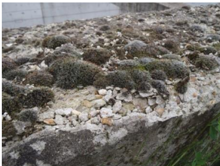
Figuur 5.9: Plaatselijke schade aan het betonoppervlak van een wandje (foto B.12 in [02])
