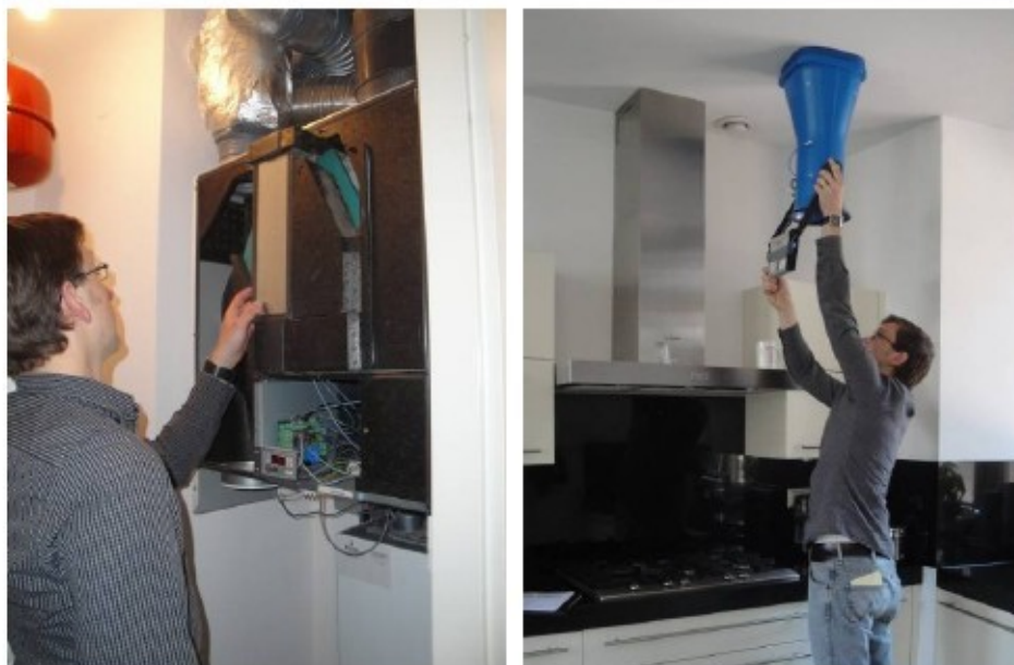
Figuur 3 (links): Visuele inspectie van het inwendige van een ventilatie-unit (balansventilatie) Figuur 4 (rechts): Meting van het ventilatiedebiet bij een afzuigventiel met behulp van een drukgecompenseerde luchtdebietmeter
