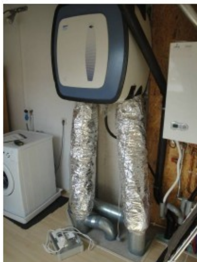
Figuur 25: Voorbeeld van een ventilatiesysteem waarbij de kanalen correct zijn geïnstalleerd. Geluiddempers zijn voldoende lang en strak gemonteerd. Bochten in de kanalen (vlak boven de verdiepingsvloer) zijn glad uitgevoerd.
