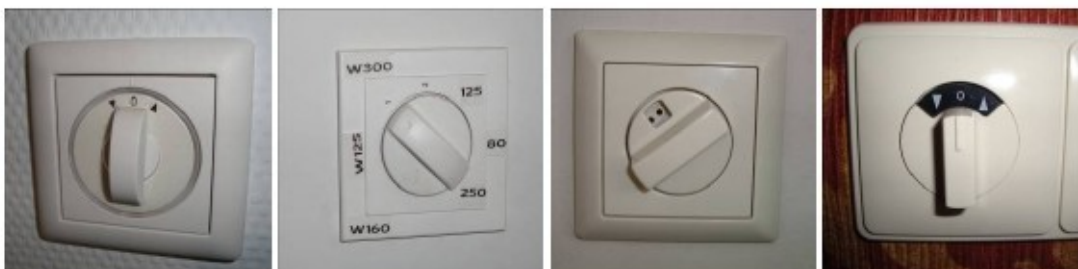
Figuur 13: Voorbeelden van bedieningsschakelaars die niet logisch zijn in gebruik. Bij deze schakelaars is het niet direct duidelijk in welke stand het ventilatiesysteem staat ingesteld en/of hoe het systeem in een hogere of lagere stand kan worden ingesteld.
