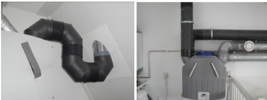
Figuur 9 (links): Het buitenluchtaanzuigkanaal is voorzien van veel bochten, waardoor de druk in de kanalen toeneemt. Hierdoor vermindert de ventilatiecapaciteit en neemt het installatiegeluidniveau toe.
