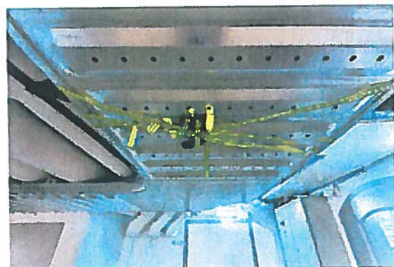
noodmaatregelen overvolle kabelgoten Eerste Kamer
