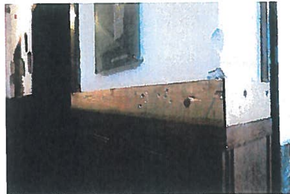
tijdelijke maatregelen afbrokkelend stucwerk Raad van State
