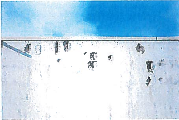
betonrot gevel Hotel Tweede Kamer
