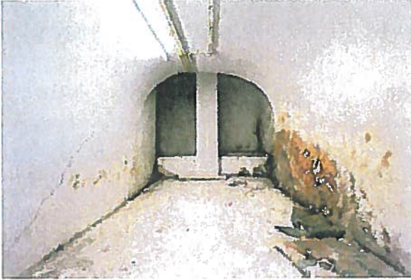
vocht in kelder Schepelhal Tweede Kamer
