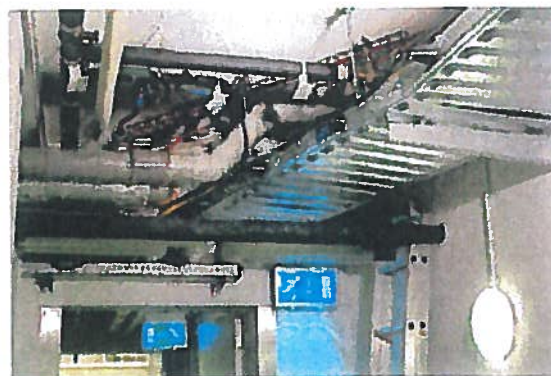
overvolle kabelgoten in combinatie met wirwar van (water) leidingen en bekabeling, BH7 Tweede Kamer
