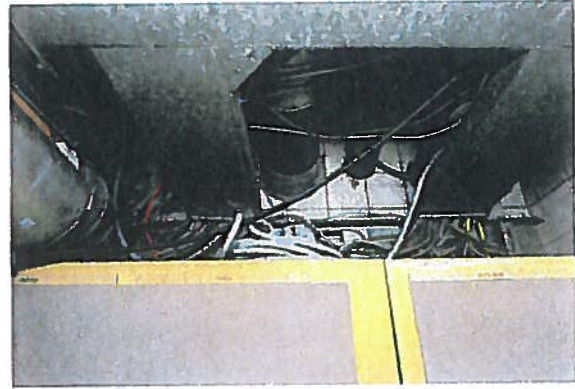
onoverzichtelijke groei van kabels- en leidingen, AZ
