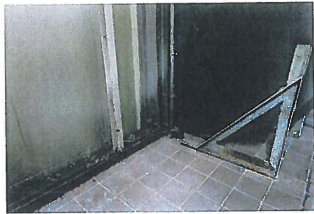
gevolgen vochtoverlast installaties AZ
