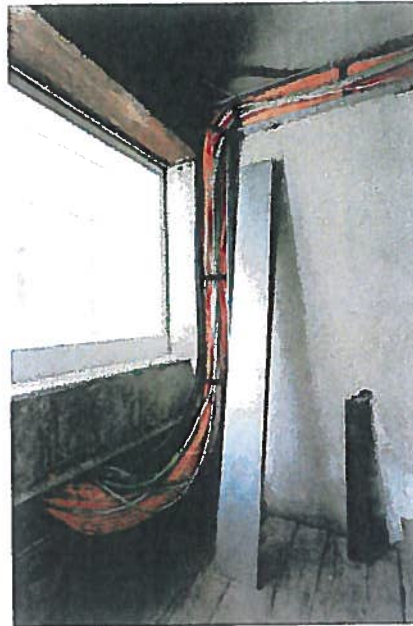
overvolle kabelgoten Eerste Kamer
