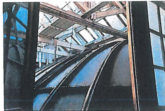
ontbreken brandscheidingen boven plafond centrale hal Eerste Kamer
