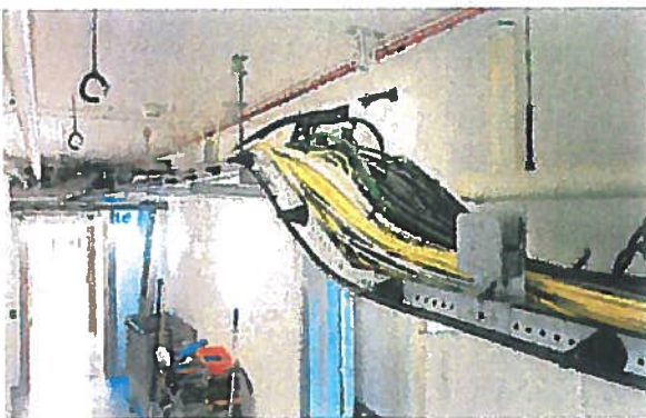
overvolle kabelgoten en ontbreken van brandscheidingen Tweede Kamer
