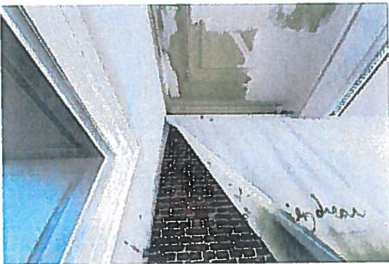
stopgezet bouwkundig herstel kantoren in afwachting renovatie Eerste Kamer
