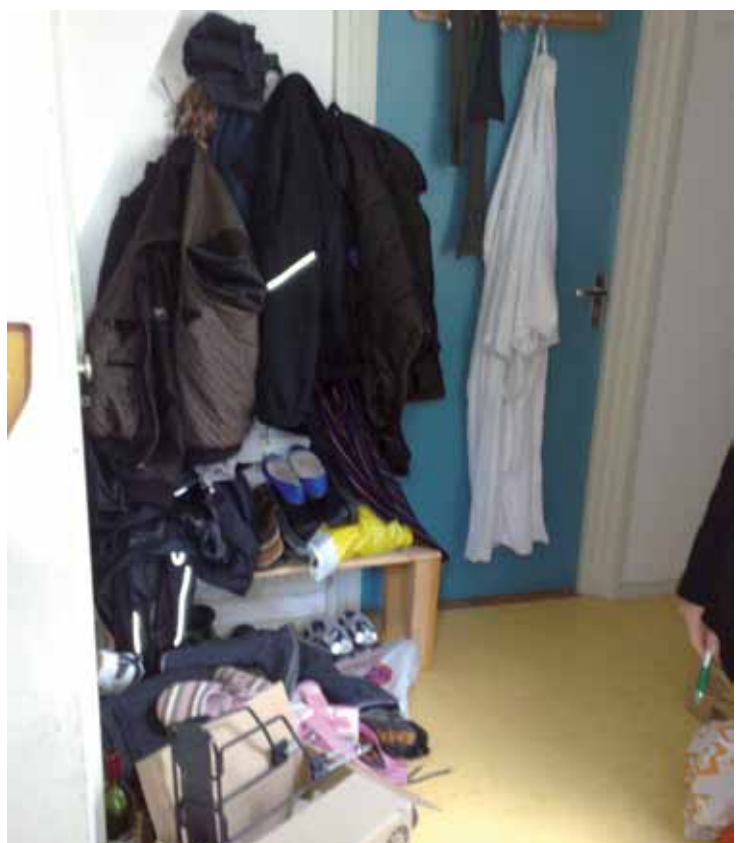
belemmeringen in vluchtweg
