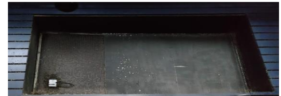
Figuur 9: Vervuild en deels afgeblind afzuigrooster zaal.
