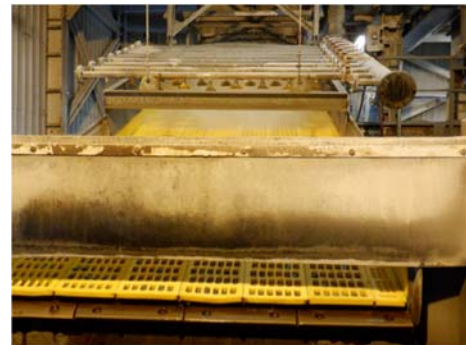
Quenast: 2 wassers met respectievelijk 8 en 9 buizen x 8 sproeiers
