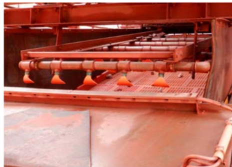
Taben-rodt: 1 wasser met 6 buizen x 5 sproeiers
