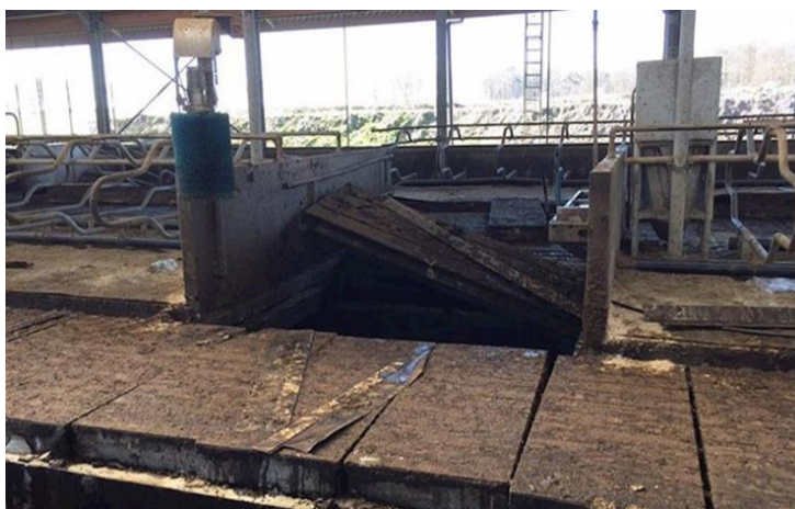
Afbeelding 7: De opgetilde vloerplaten door de explosie
