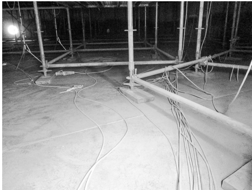
Meetlocatie 1C: Verontreiniging op de vloer van de tank nadat deel van de steiger is afgebroken
