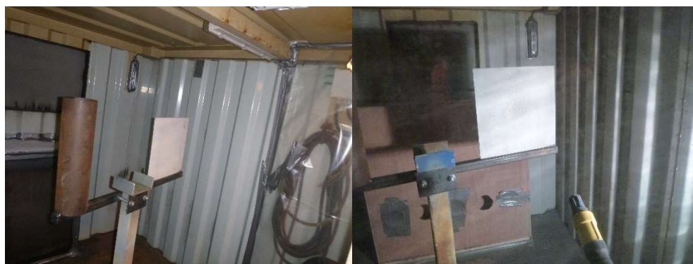
Figuur 6: Opstelling in straalcontainer, met de filterunit (links) en de constructie voor laten neerslaan van (grof) stof voor de filterunit (rechts).
