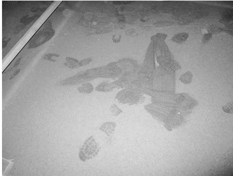
Meetlocatie 1C: Aanwezigheid verontreinigd straalgrit op de vloer van de tank (doorheen gelopen tijdens activiteit 'verplaatsen/inspectie')
