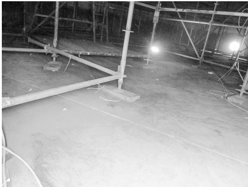
Meetlocatie 1C: Verontreiniging op de vloer van de tank nadat deel van de steiger is afgebroken, inclusief positie stationair meetpunt in de tank tijdens werkzaamheden
