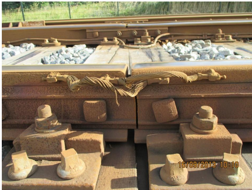
Figuur 3. Foto van de gescheurde lasplaat van wissel 105B
