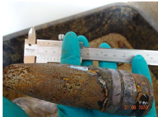
Figuur 31 Corrosie rond geleideband.
