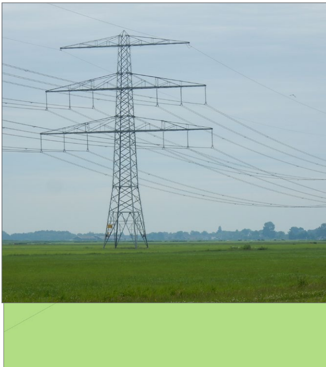
fig: 3 Bestaande vakwerkmast 4x220kV
