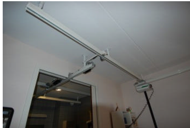
Plafondtiltsysteem van slaapkamer naar badkamer
