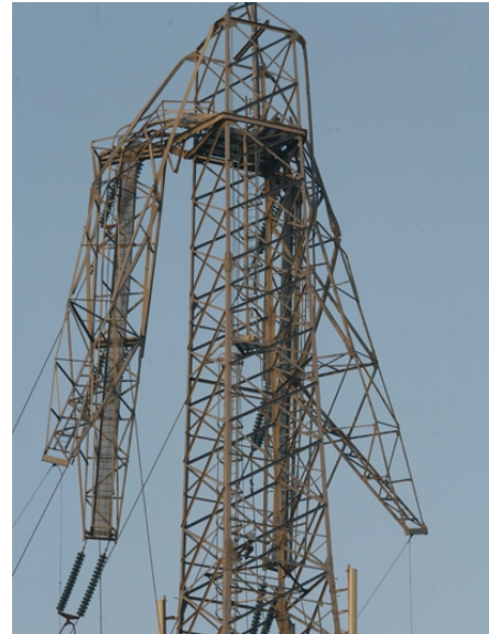
Figuur 8: Beschadiging van dubbelcircuit mast door helikopter.
