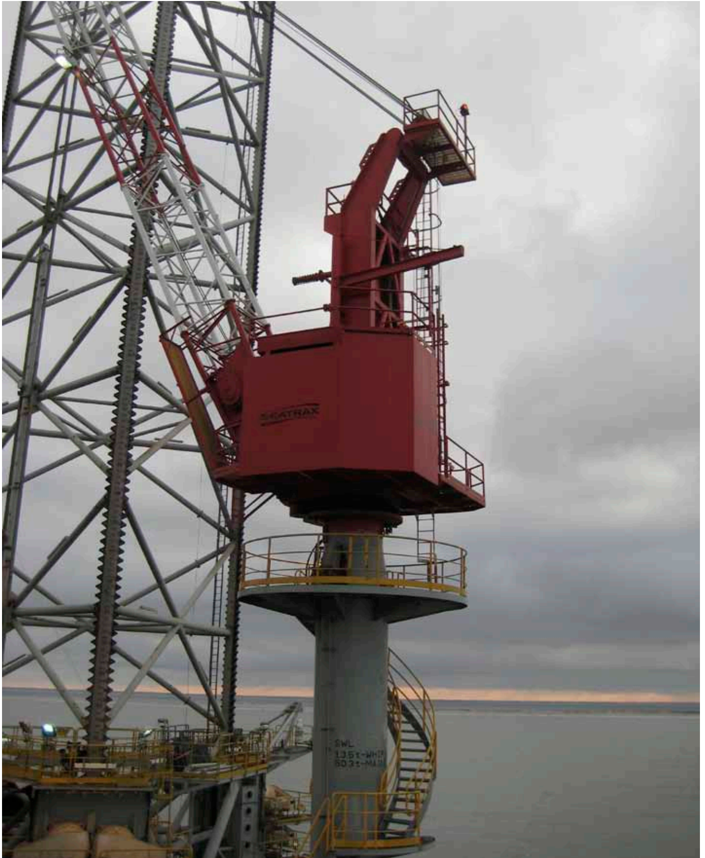
Waar is de nooduitgang? Offshore kraan aan boord van een mobiele boorinstallatie met één lange trap naar de kraancabine (foto SoaM)
