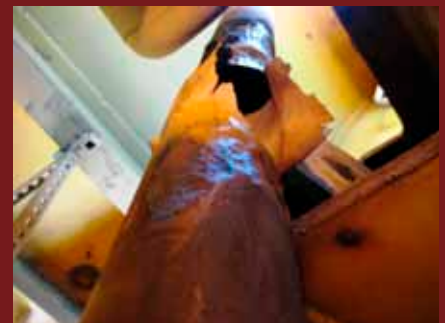
Gescheurde ventleiding door externe corrosie (foto SodM)
