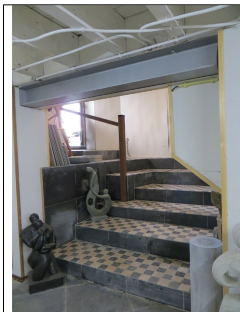
Figuur 5: brandscheiding tussen twee gebruiksfuncties twijfelachtig; plafond ligt open
