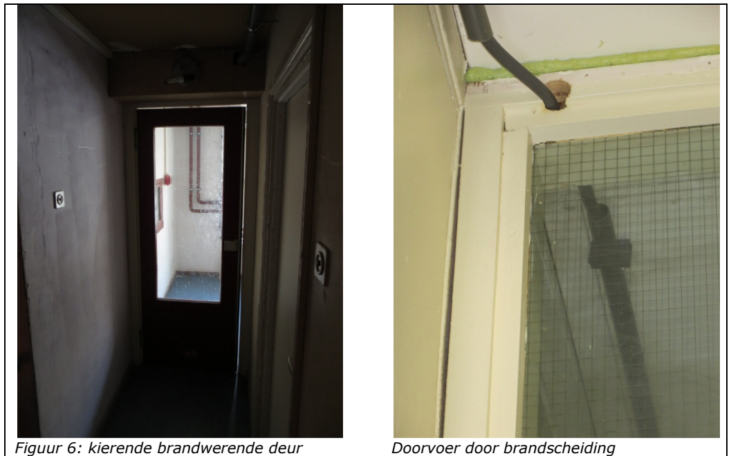
Figuur 6: kierende brandwerende deur
