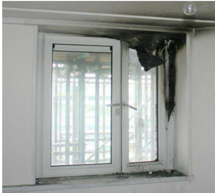
Figuur 9 Voorbeeld van een kozijn waarin de aansluiting van de ramen op de kolommen is bezweken en het glas nog intact is
