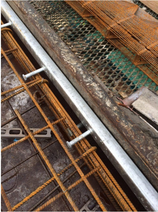
Figuur 13 Onjuist aangebrachte ankerrail t.b.v. geveldragers blok 15 (foto Toezicht Bouw Stadsdeel Oost 31-08-15)
