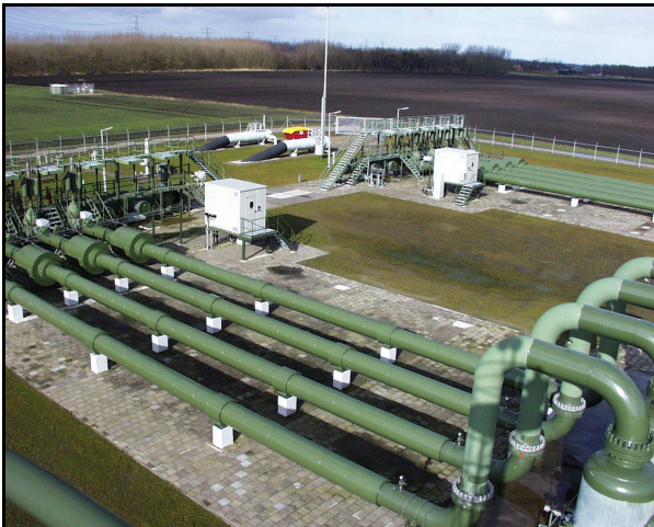
Het gashoeveelheidsmeetstation te Tjuchem (foto: SodM)
