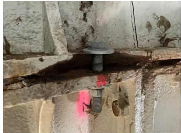
Figuur 4.2: Scheur in het paneel en afgebroken flens als gevolg van vervangen van bouten. Groot gedeelte van de voeg is hier niet meer intact.
