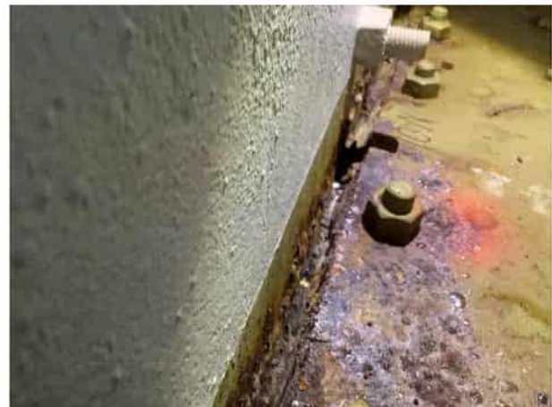
Figuur 4.8: Overzicht van corrosie, delaminatie en vocht ter plaatse van het lijf en vloerplaat.
