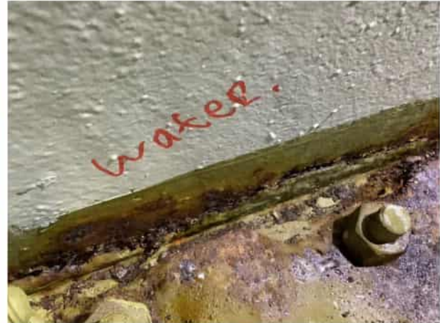
Figuur 4.6: Overzicht van corrosie, delaminatie en vocht ter plaatse van het lijf en vloerplaat.
