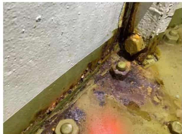
Figuur 4.10: Overzicht van corrosie, delaminatie en vocht ter plaatse van het lijf en vloerplaat.
