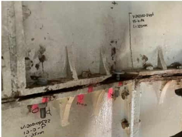
Figuur 4.1: Scheur in het paneel en afgebroken flens als gevolg van vervangen van bouten. Groot gedeelte van de voeg is hier niet meer intact.
