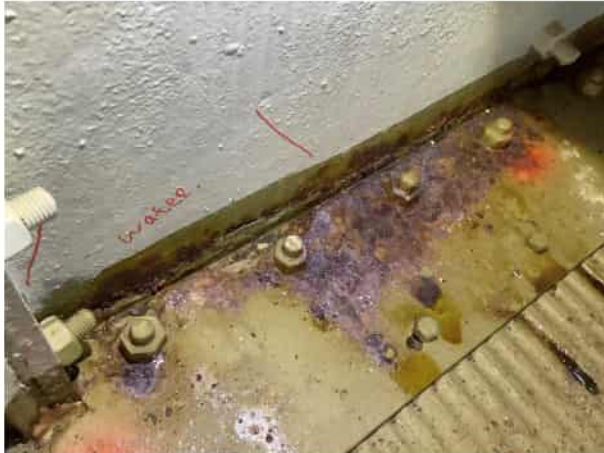
Figuur 4.5: Overzicht van corrosie, delaminatie en vocht ter plaatse van het lijf en vloerplaat.
