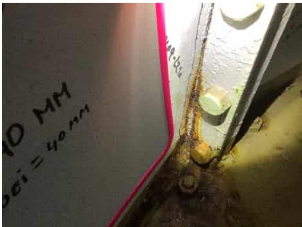
Figuur 4.3: Scheur tussen flens en lijf staat verder open door toedoen van delaminatie.
