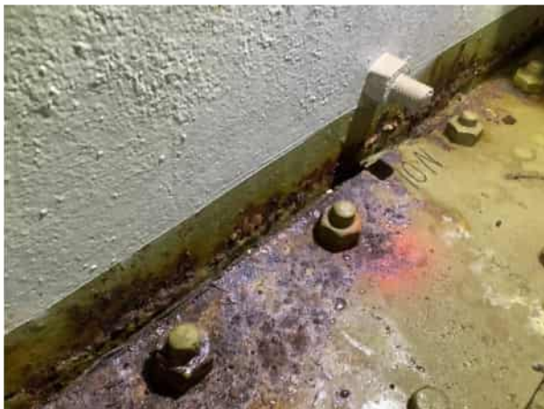
Figuur 4.7: Overzicht van corrosie, delaminatie en vocht ter plaatse van het lijf en vloerplaat.
