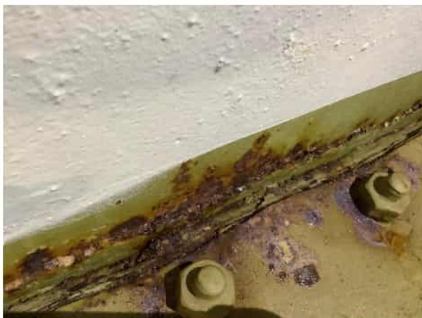
Figuur 4.9: Overzicht van corrosie, delaminatie en vocht ter plaatse van het lijf en vloerplaat.
