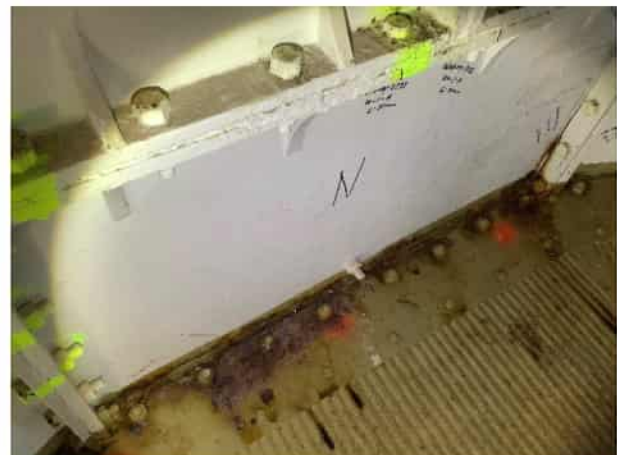
Figuur 4.4: Overzicht van corrosie, delaminatie en vocht ter plaatse van het lijf en vloerplaat.
