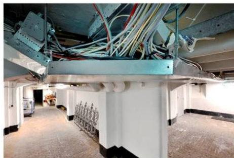
Overvolle kabelgoten met technisch en veiligheidsrisico
