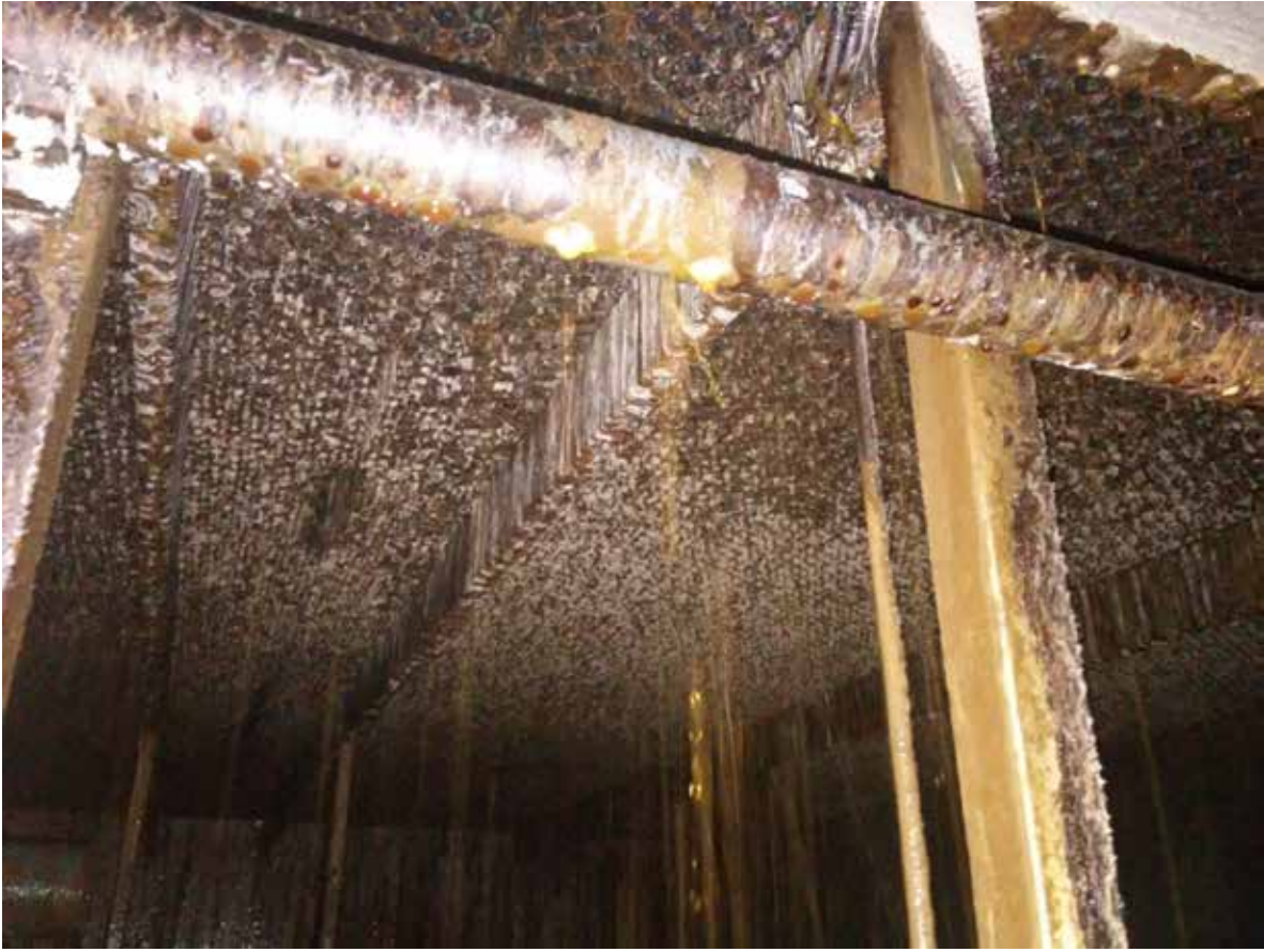
Figuur 9 Biofilm is zichtbaar op constructie en waspakket.
