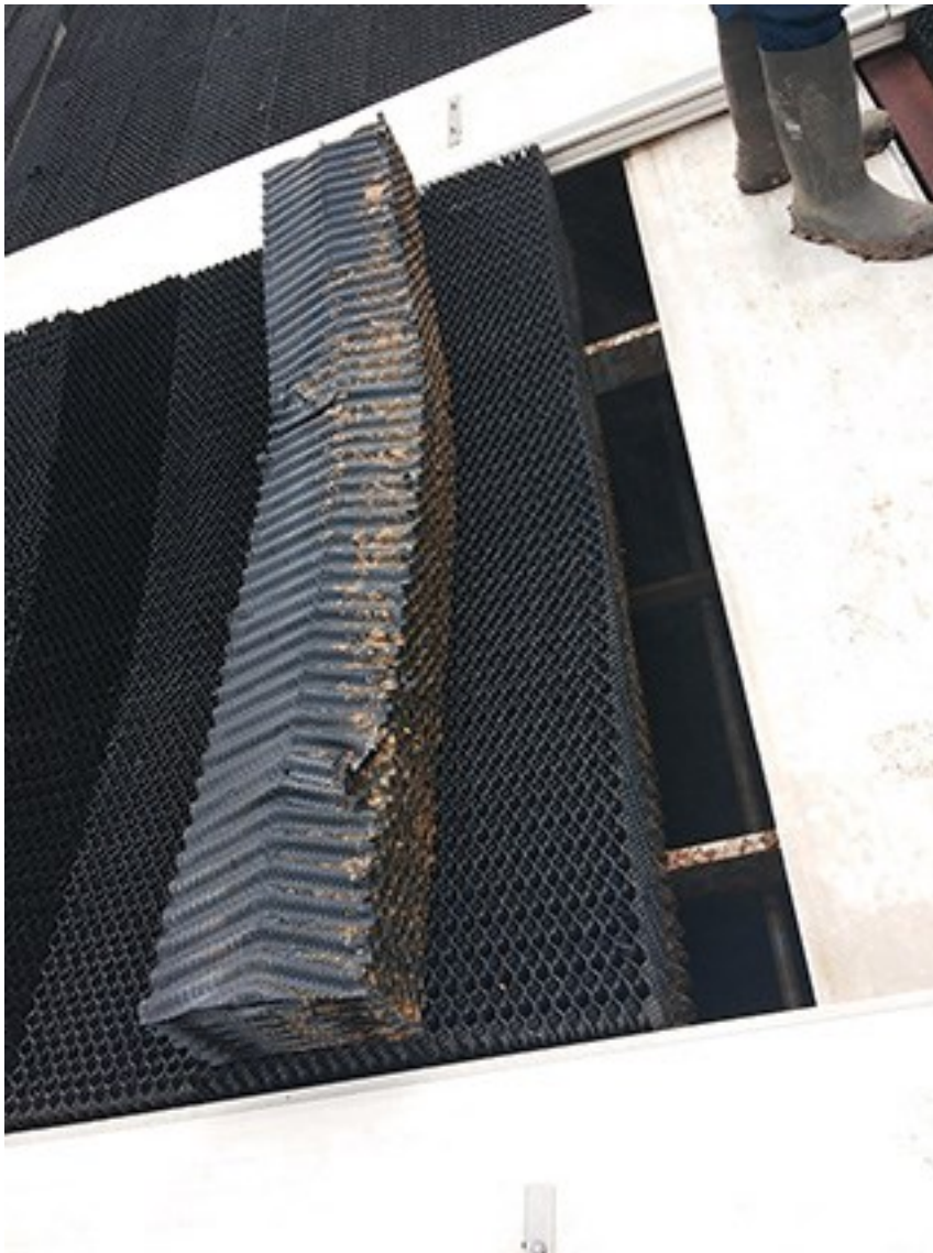
Figuur 13 Bovenaanzicht van de luchtuitlaat van de biologische luchtwasser; het zwarte kunstofpakket is de druppelvanger. Eén van de druppelvangermodules is verwijderd en ligt op zijn kant op de andere druppelvangermodules. Op de verwijderde druppelvangermodule is geel-bruine biofilm zichtbaar (aan de kant waar de sproeiers zich bevinden).
