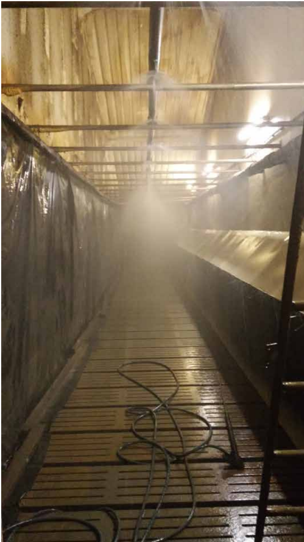
Figuur 11 Stofwasstap type A. De lucht verlaat de stofwasstap onderaan aan de rechterzijde op de foto, waar zich het waterbassin en het waspakket van de biowasstap bevindt.
