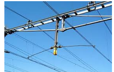
Afbeelding 2: detail van het bovenleidingssysteem
