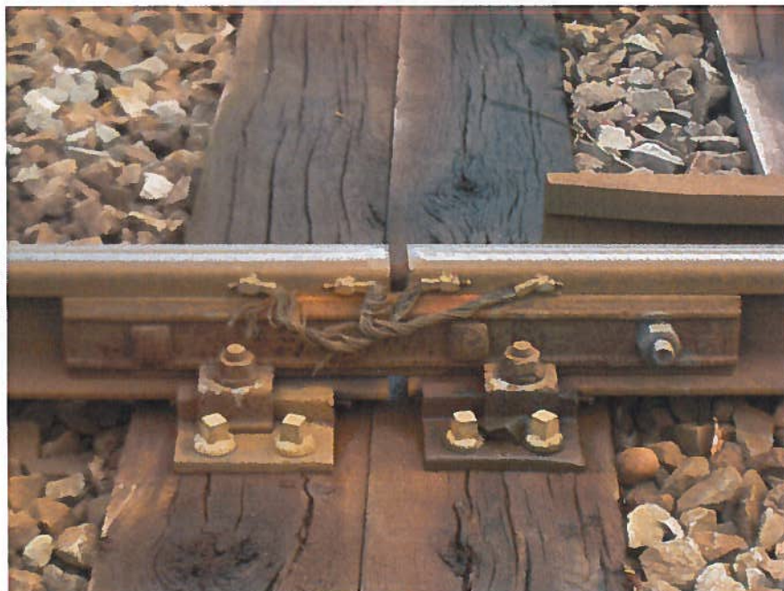
Figuur 17. Opening van 20 mm in las, en ontbrekende boutverbinding
