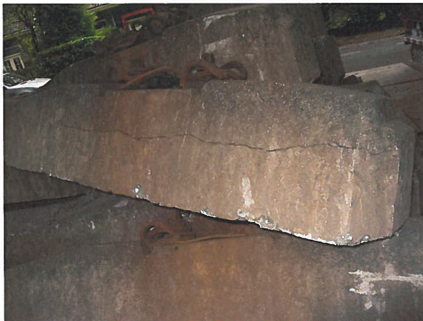
Figuur 12. Scheur in betonnen dwarsligger te Baarn, van de onderkant gefotografeerd, na verwijdering
