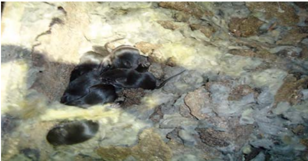
Figuur 4.4.2 Nestje tussen het isolatiemateriaal (Bron: M. Verboeket)
