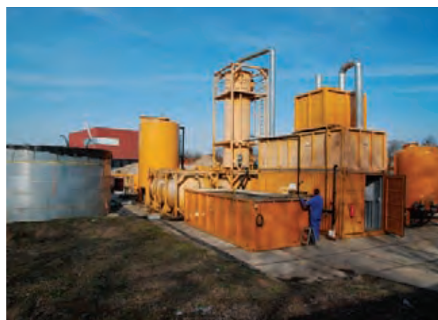
Sanering van het voormalige REGEV-gasfabriekterrein in Hilversum – zuiveringsinstallatie voor het vervuilde grondwater
