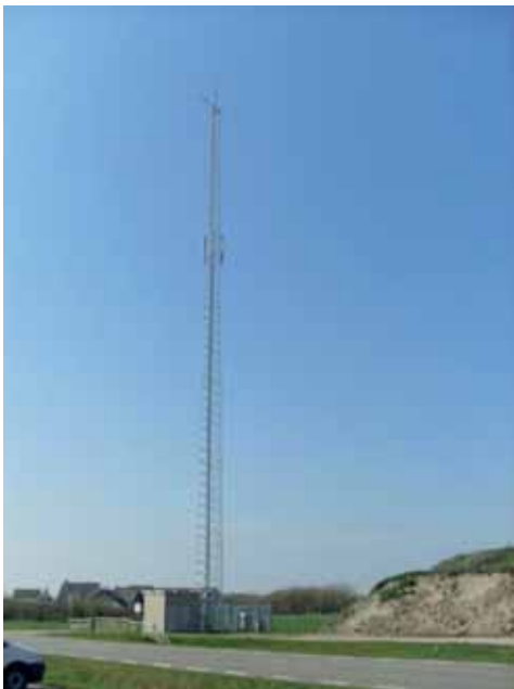
Figuur 3.28 C2000 mast (voorbeeld)
