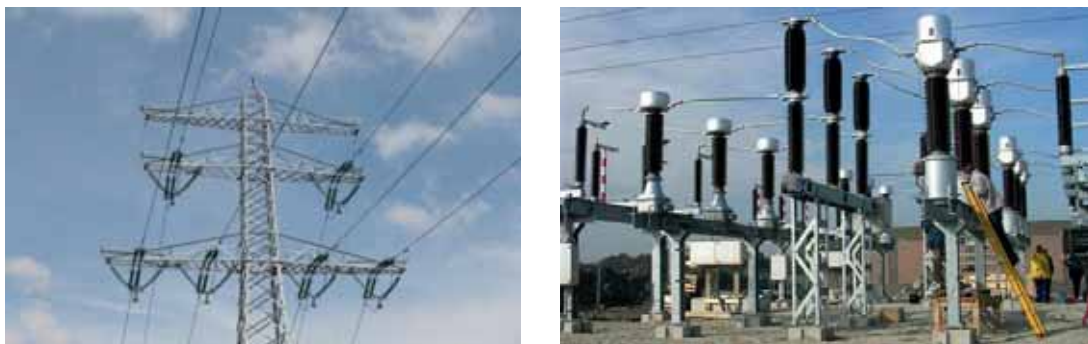
Figuur 3.26 Hoogspanningsmast en verdeelstation (voorbeelden)
