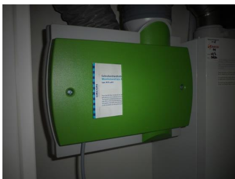
Figuur 24: ventilatieafvoer unit woning 65
