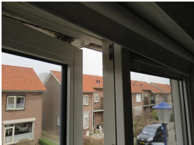
Figuur 58: kierdichting woning 167
