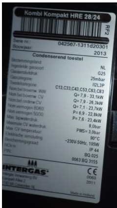
Figuur 26: Typeplaatje + bouwjaar CV-ketel woning 68
