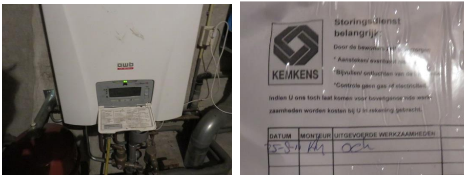
Figuur 55: CV-ketel met onderhoudssticker woning 166
