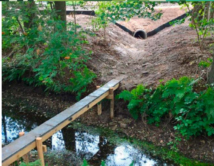
Voorbeelden van maatwerk kleine faunavoorzieningen bij Overberg (UT8).
