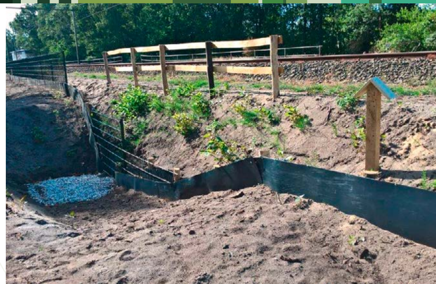
Voorbeelden van maatwerk kleine faunavoorzieningen bij Overberg (UT8).
