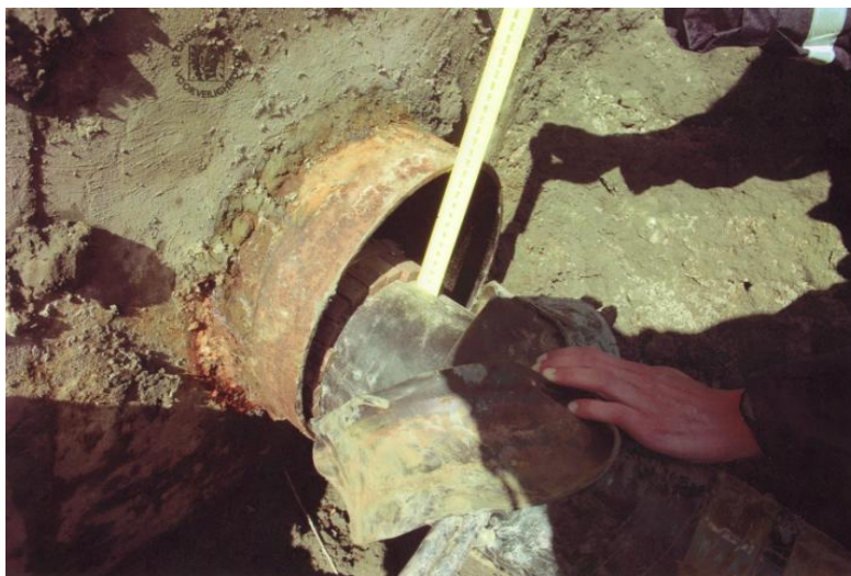
Foto 5-6 Doorvoering in het eindgebouw Zuid (buitenzijde) van de H2-leiding onmiddellijk na het incident (ref. 1.r)
