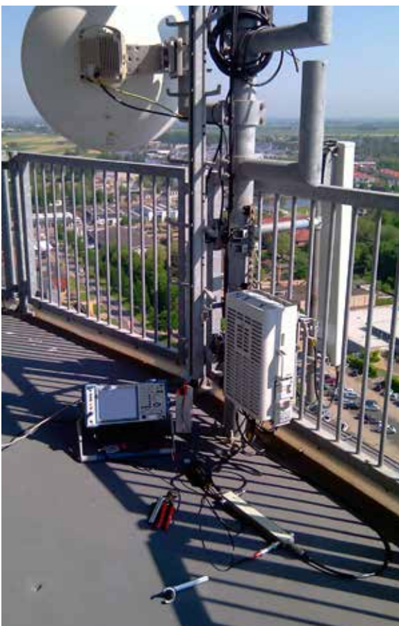
Meting ongewenste emissie bij LTE basisstation Telez
