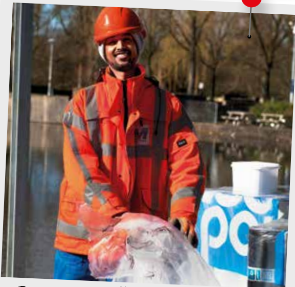
Semere werkt bij Markus B.V. aan de grondsanering vlakbij zijn woning op Startblok Riekerhaven
